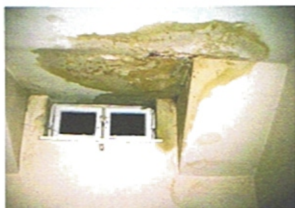
foto 4. Sufit klatki schodowej (czerwiec 2010 r.)
