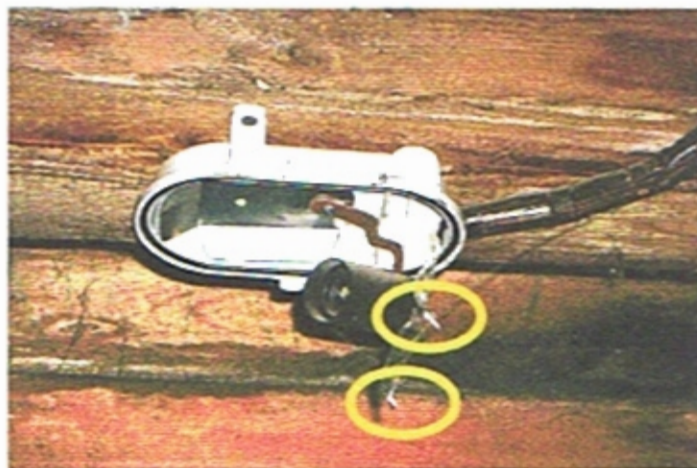
foto 9. Strych - instalacja elektryczna pod napięciem.
